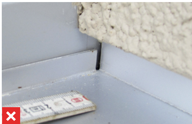
Abb. 17 Offene Innenecke zwischen Putzbord und hinterer Aufbordung
