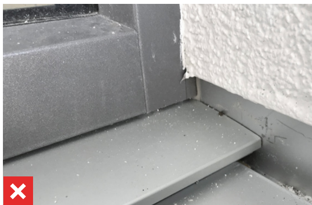
Abb. 18 Fehlende Dehn- und Stauchzone bei entkoppeltem Putzbord aufgrund eines zu langen Wetterschenkels
