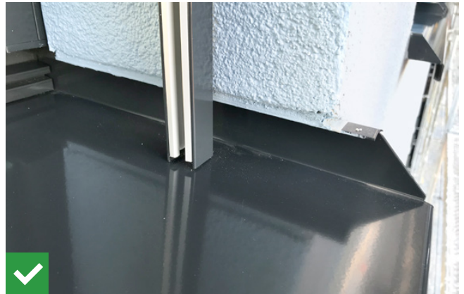
Abb. 11 Putzbordanschluss mit sichtbarem Fugendichtungsband mit Farbe beschichtet
