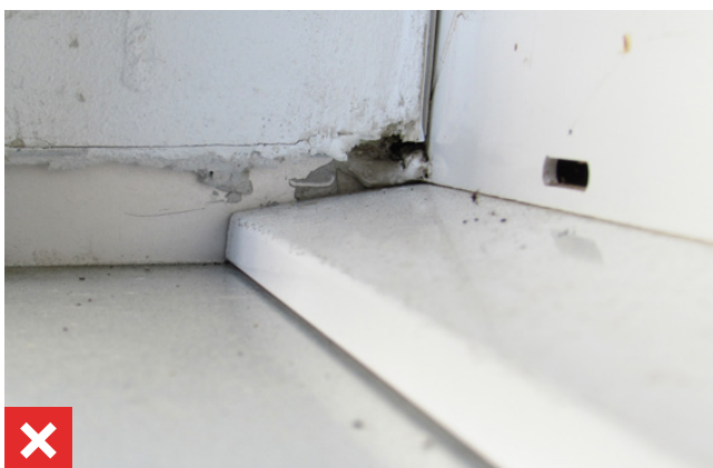
Abb. 27 Gewerke Loch durch zu kurzes Putzbord
